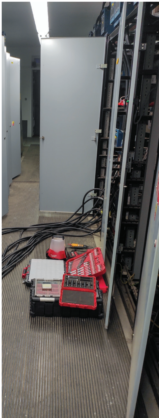
Připojení náhradních zdrojů do nízkonapěťové rozvodny
